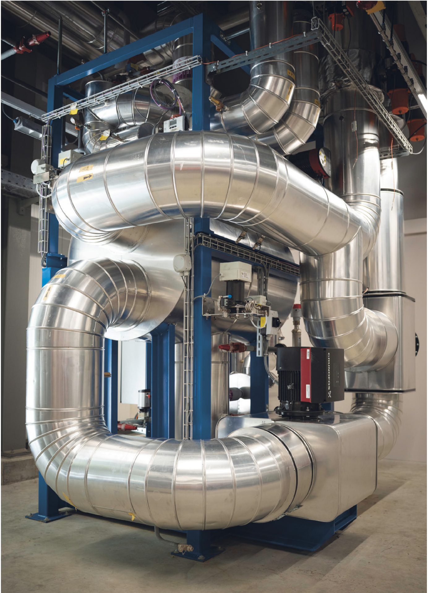
Heizzentrale Wärmeverbund Worblental, EBL.
